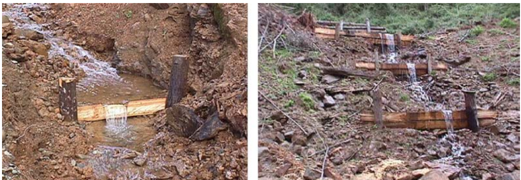
Figura 12.2. Preservación de la calidad del agua mediante construcción de alcantarillas, control de la erosión y del arrastre de sedimentos.
